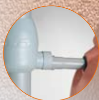
Conexión entre ánfora y filtro de bajante
